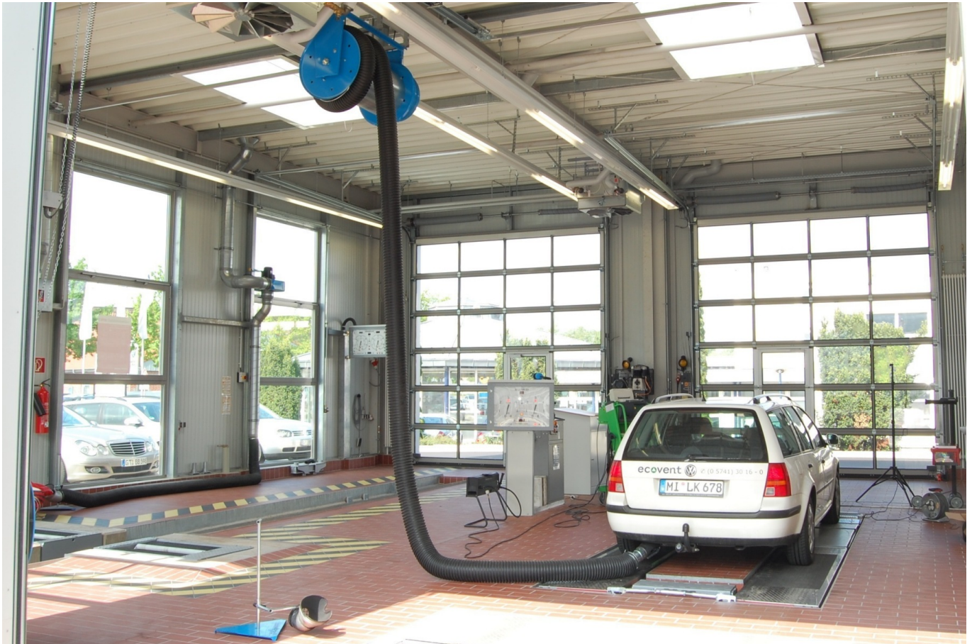
Abgasschlauchaufroller in einer Prüfstation
